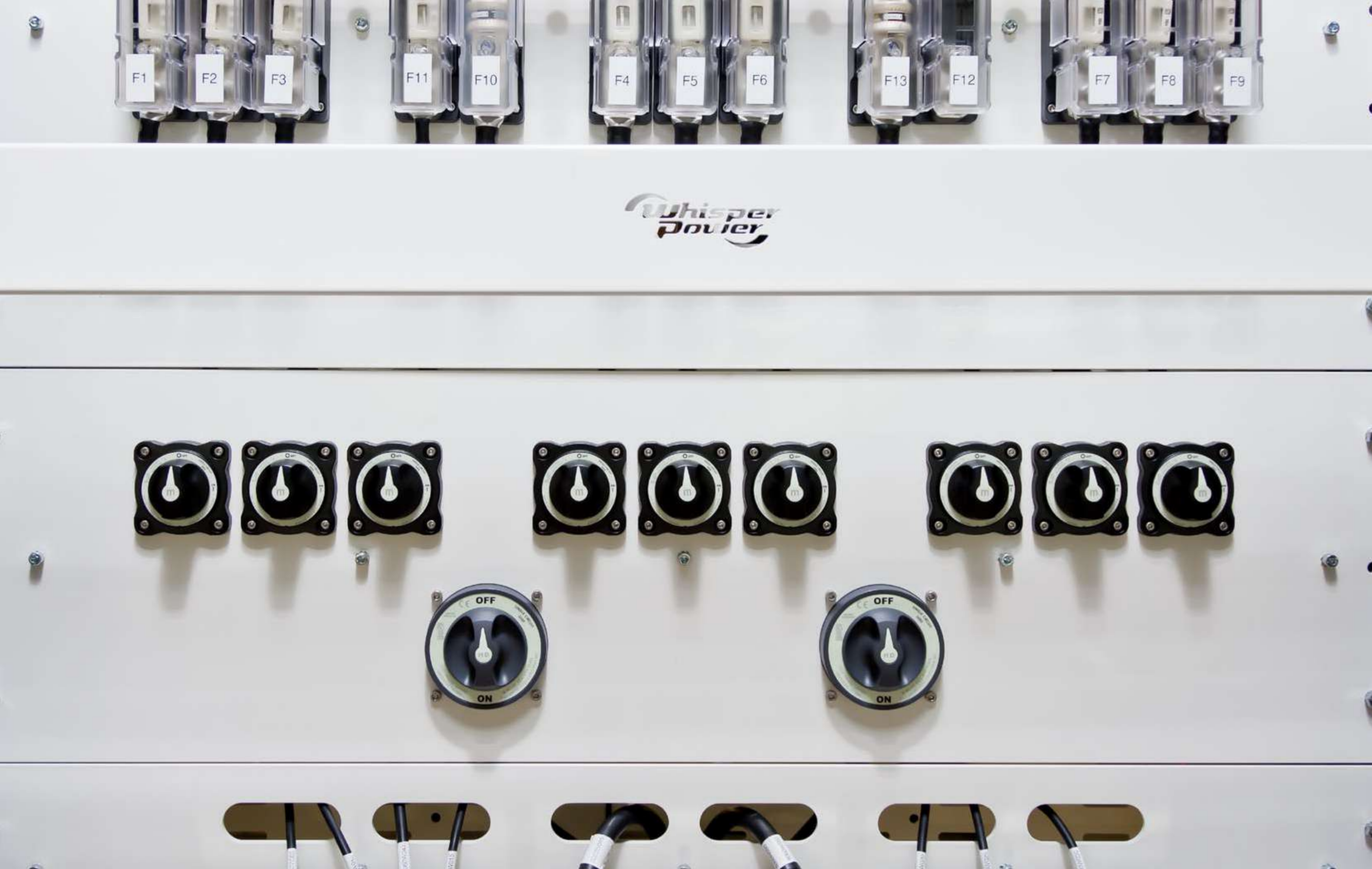
Distribución de Energía
